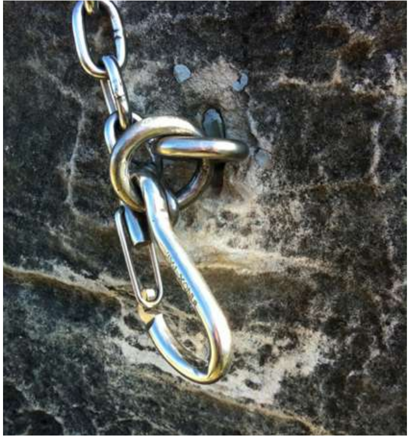
Descuelgue instalado sin la resina apropiada, con los taladros de una métrica incorrecta y con desgaste en el mosquetón de descuelgue. El giro de 90° del tensor se realizó con la mano antes de proceder a su sustitución. El ángel de la guardia a veces trabaja demasiado.
