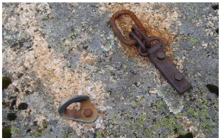
Spit de 8 mm como reequipamiento/refuerzo del rápel. Esto ya cumplió su función. Foto Archivo FMM.
