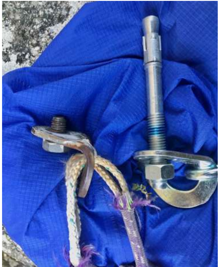
Spit de 10mm esperando ser sustituido por parabolt 12mm .
